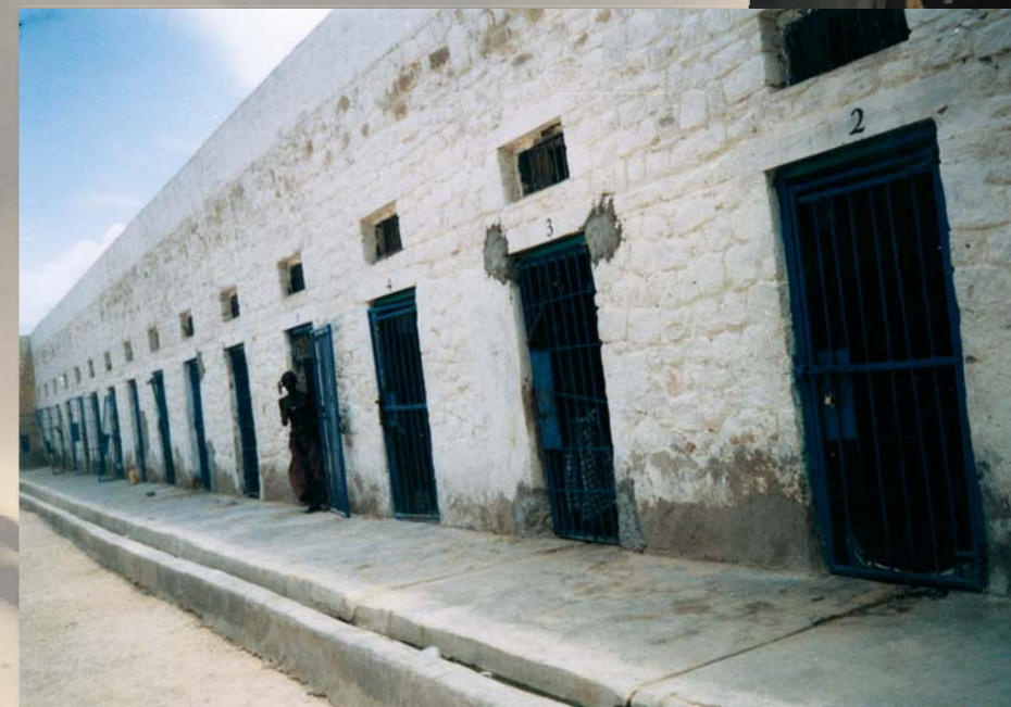
In diesem ehemaligen Gefängnis in der Hafenstadt Berbera werden psychisch Kranke verwahrt. Gezielte ärztliche, pflegerische und medikamentöse Betreuung und Versorgung gibt es nicht. Fotos: privat
